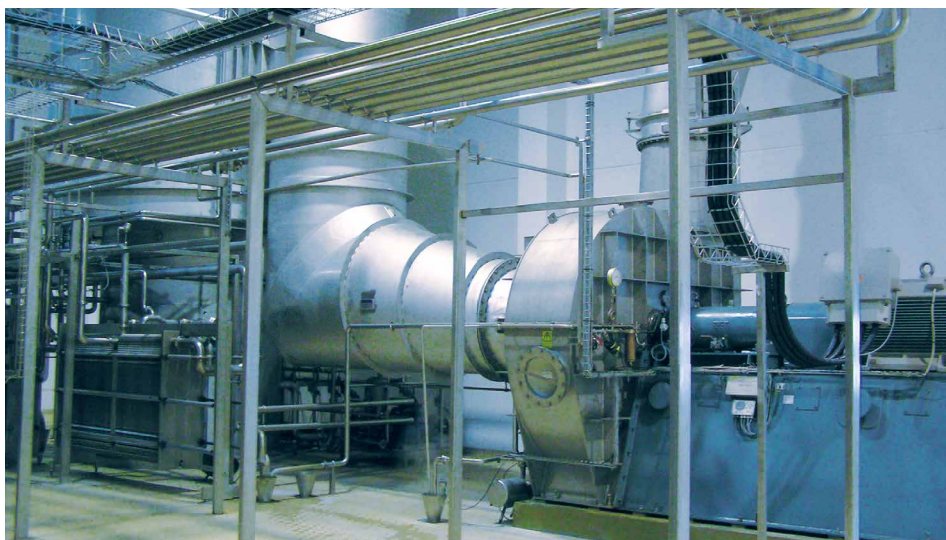
Ventilator in einer Brüdenanlage
