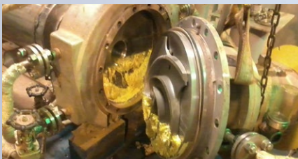
Beispiele kristalliner Schwefelleckage außerhalb und innerhalb von Pumpen
