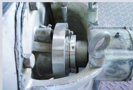
EagleBurgmann PowderAce eingesetzt in einer Zellenradschleuse eines japanischen Betreibers
